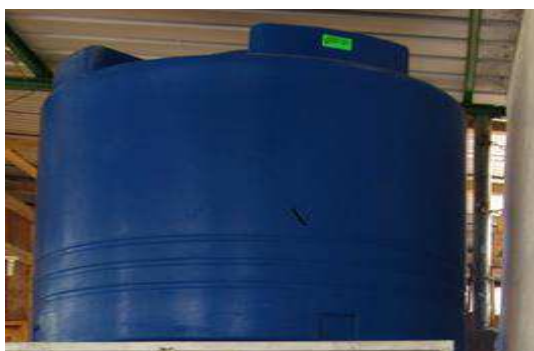
Ilustración 4.17: Tanque de Agua
