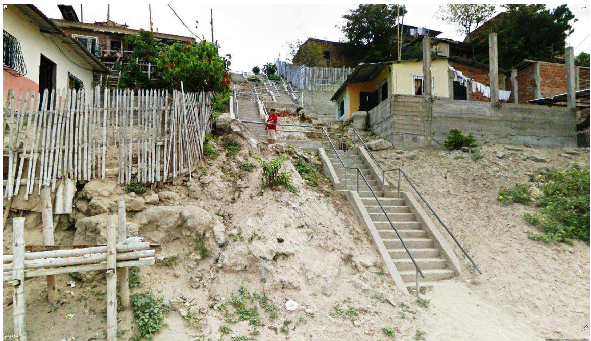
Ilustración 17 Escalinata en estado de deterioro del Barrio 2 de Agosto-Manta
