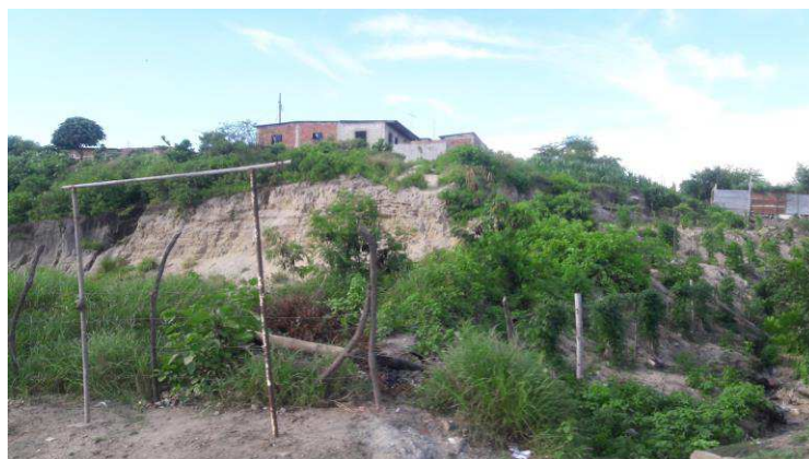
Barrio “2 de agosto”- ladera con presencia de movimiento de tierra
