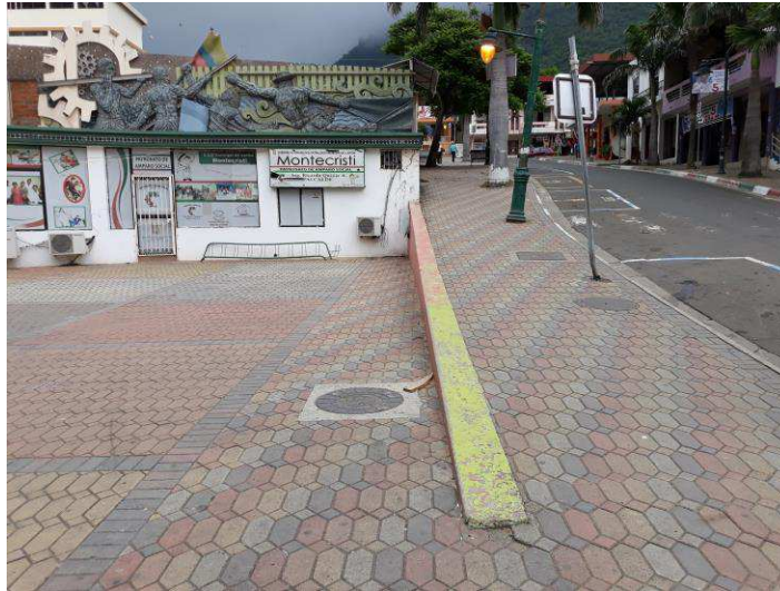
Figura 29: Tratamiento sin piso podotáctil. Calle 9 de Julio.
