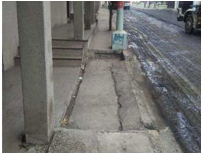
Figura 30: Aceras con desniveles. Calle Sucre.
