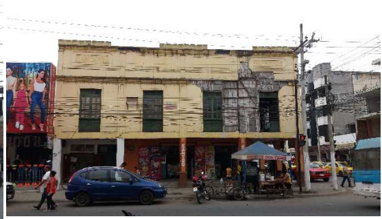
Gráfico # 8: Fachada de la vivienda "Carlos Colamarco" se identifica el daño producido por el sismo del 16A
