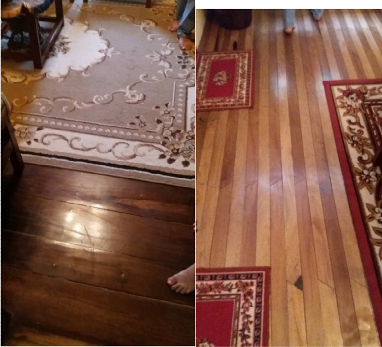
Anexo # 12 Vivienda Herederos Herrera miranda, suelo del segundo piso
