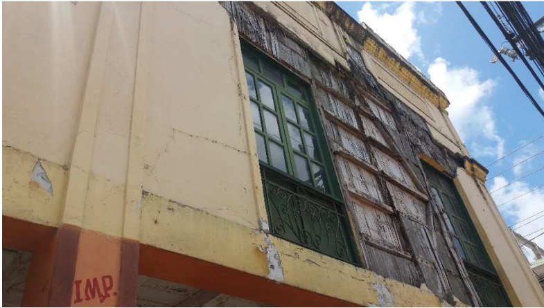
Anexo # 2 Vivienda Carlos Colamarco, sección desprendida de la fachada
