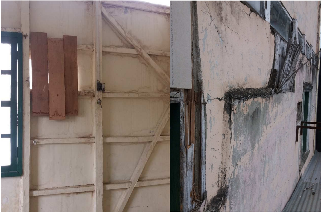
Gráfico # 34: Daños provocados en las paredes por humedad, zona interior y exterior 26/05/2018
