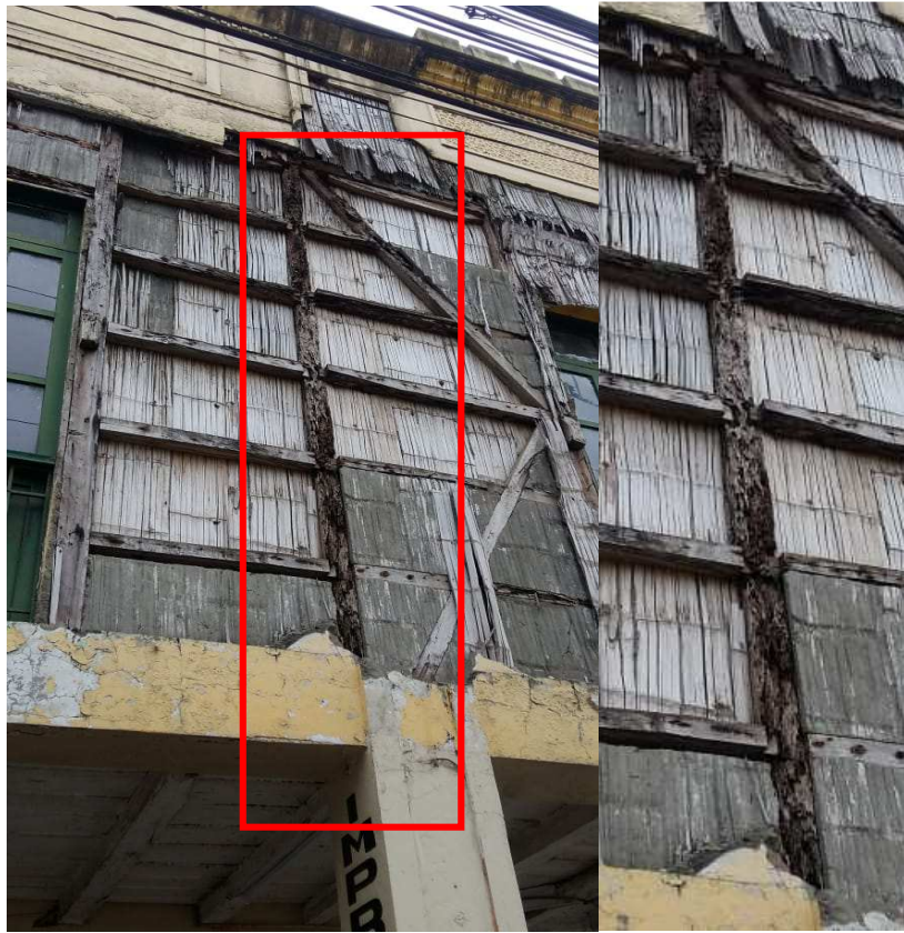
Gráfico # 30: Desprendimiento en enlucido donde se identifica daño en columna producido por xilófagos 26/05/2018
