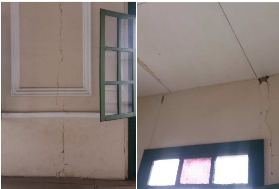
Gráfico # 35: Daños en por desprendimiento del enlucido en paredes interiores 26/05/2018
