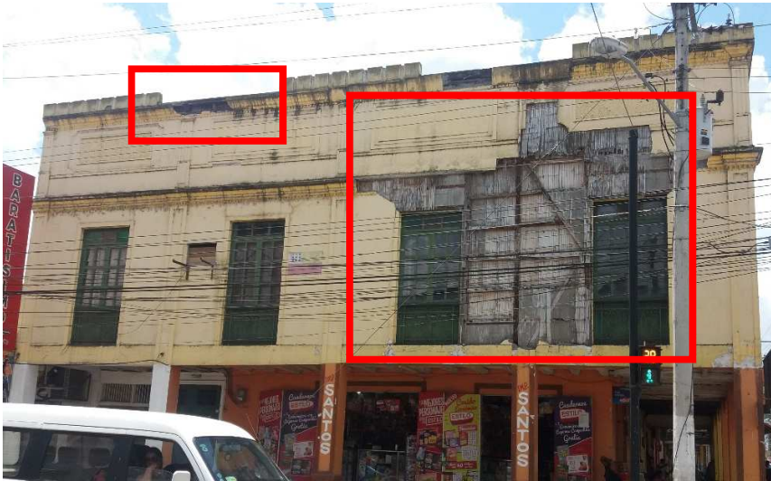
Gráfico # 40: Desprendimiento en enlucido 26/05/2018
