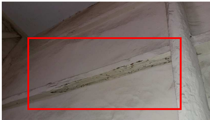
Gráfico # 31: Daños en elementos estructurales de madera producido por xilófagos 26/05/2018
