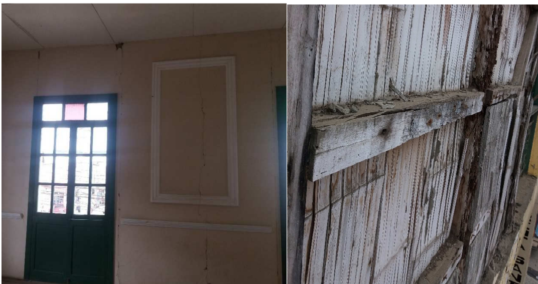
Gráfico # 33: sección de pared que será reemplazada debido a daños producido por xilófagos y humedad, zona interior y exterior 26/05/2018
