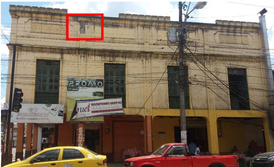
Gráfico # 41: Desprendimiento en enlucido 26/05/2018
