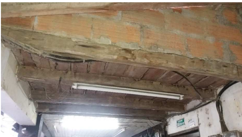
Anexo # 7 Vivienda Marlon Zambrano, cielo raso del portal
