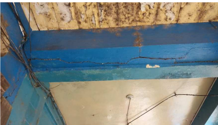
Anexo # 10 Vivienda Patricia Plama de Vera, viga en el portal
