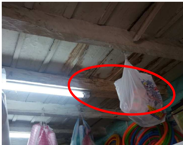
Gráfico # 29: Daño por humedad identificado en viga 26/05/2018
