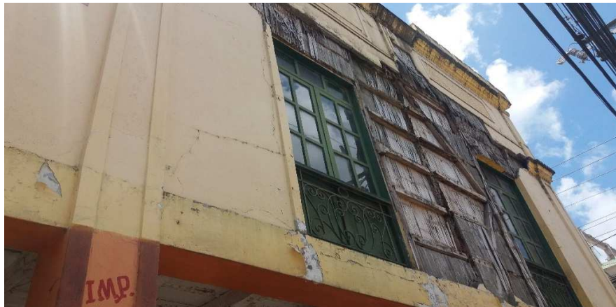
Gráfico # 39: Desprendimiento en enlucido donde se identifica daño en paredes producto de la humedad y xilófagos 26/05/2018
