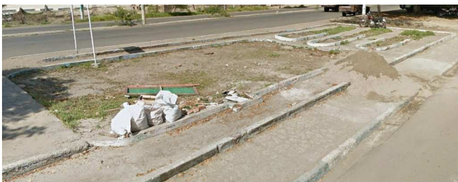
Ilustración #55: Mal estado de bordillos y aceras (Espacio Público)
