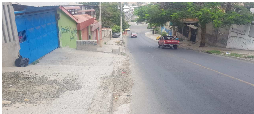
Anexo fotográfico 9. Aceras sin uniformidad y en mal estado.
