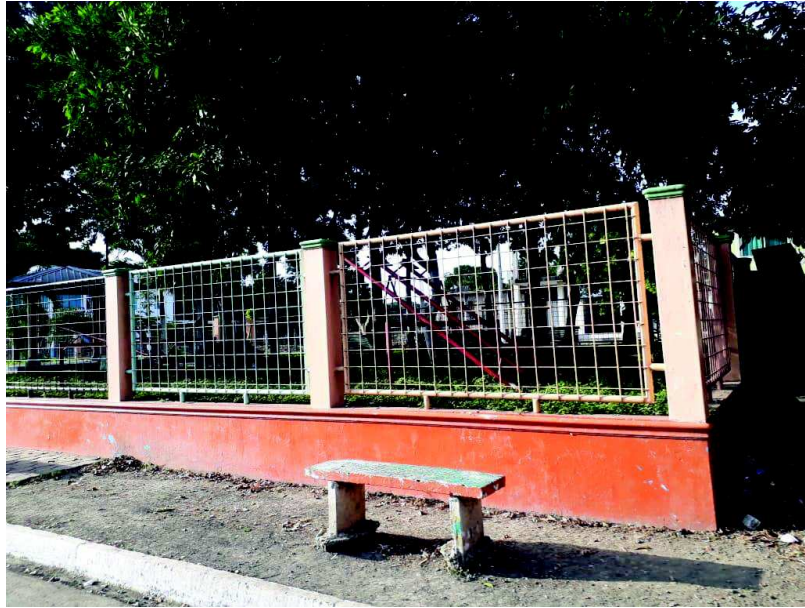
Deterioro de mobiliario urbano cerca al parque
