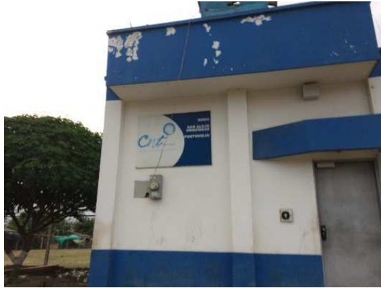
Nodo de la empresa de telecomunicación ubicado sobre la calle Santa marianita Junto al Terreno de propuesta Fuente: Joseph Intriago
