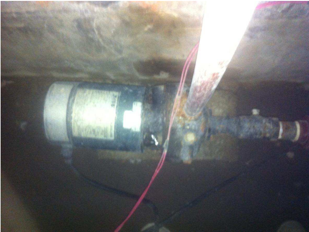
Bomba de instalaciones en la investigación
