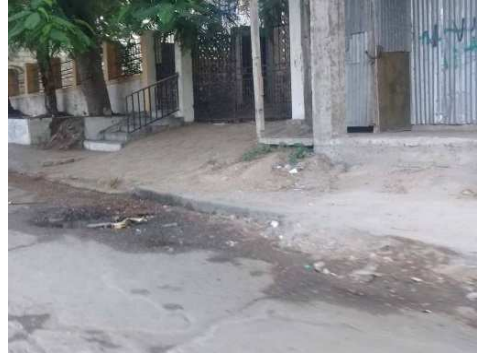
Imagen 3: Acera en mal estado. Fuente: Marjorie Santos.
