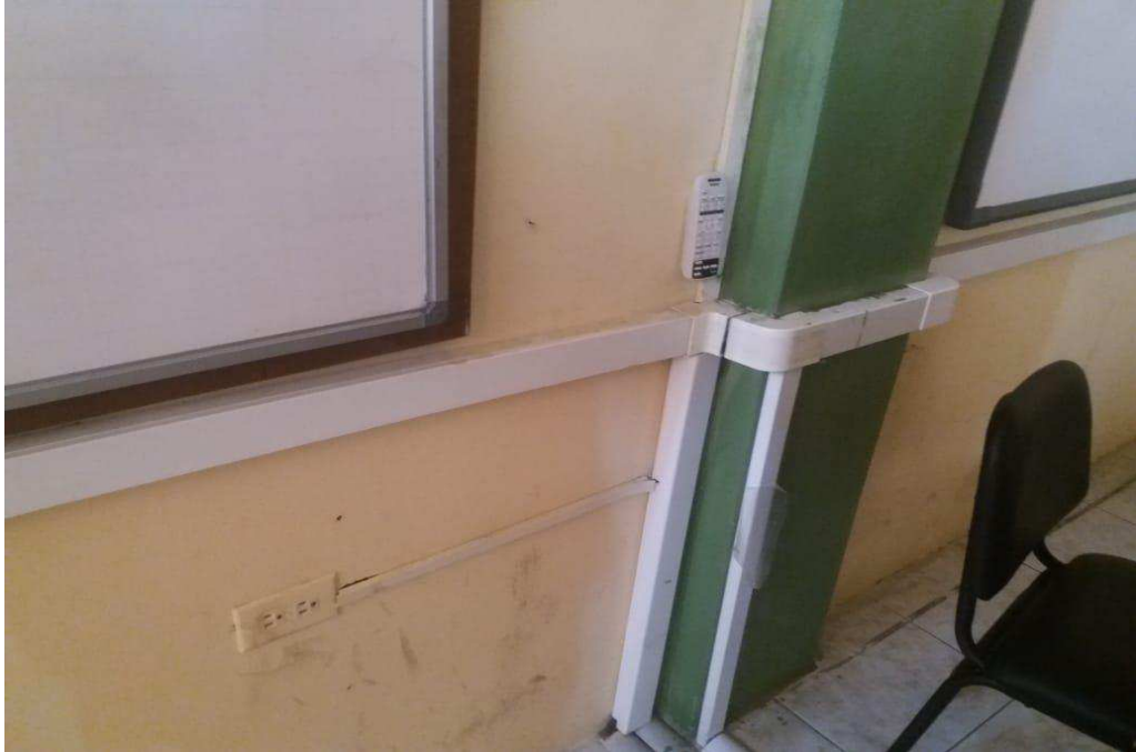
Anexo 15: Cable eléctrico no apantallados y cables UTP en la misma canaleta Autor: Mauro Ramírez
