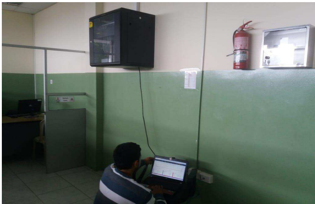
Anexo 6: Realizando el análisis a los puntos de conexión del Switch R1 (Sala de profesores 3).
