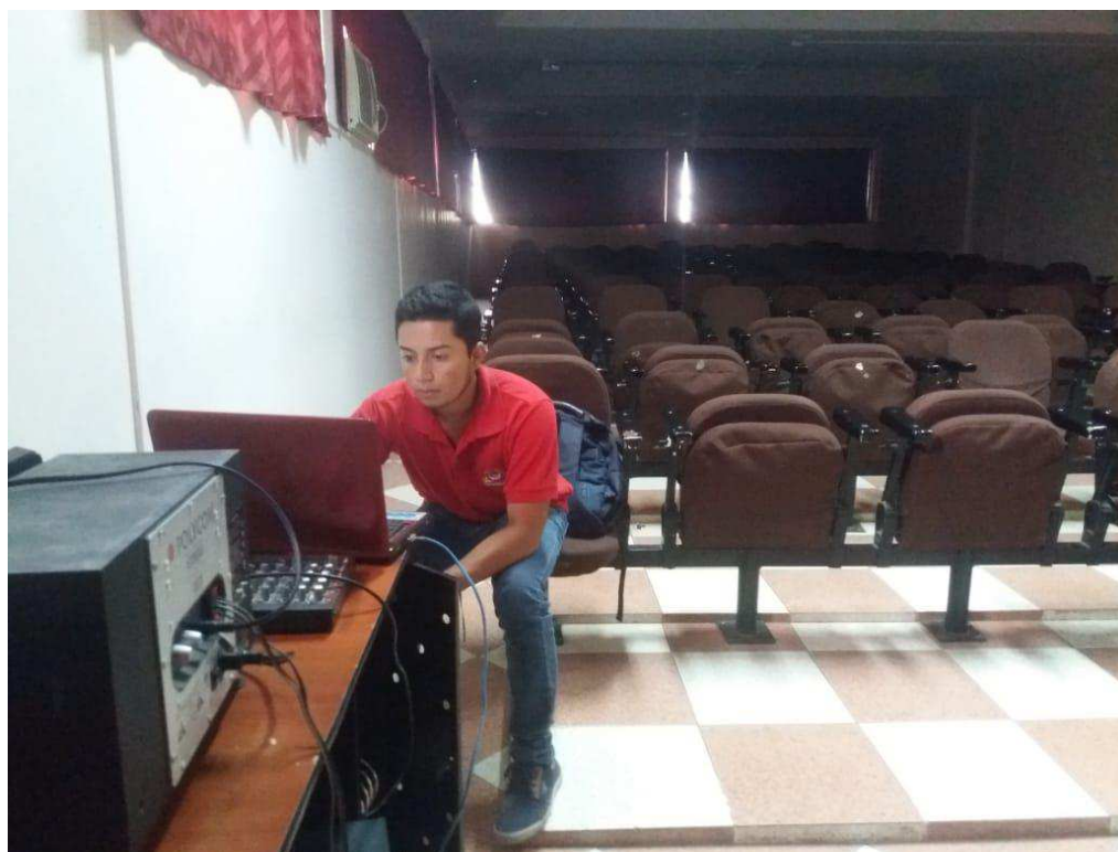
Anexo 5: Realizando el análisis a los puntos de conexión del Switch R9 (Auditorio).
