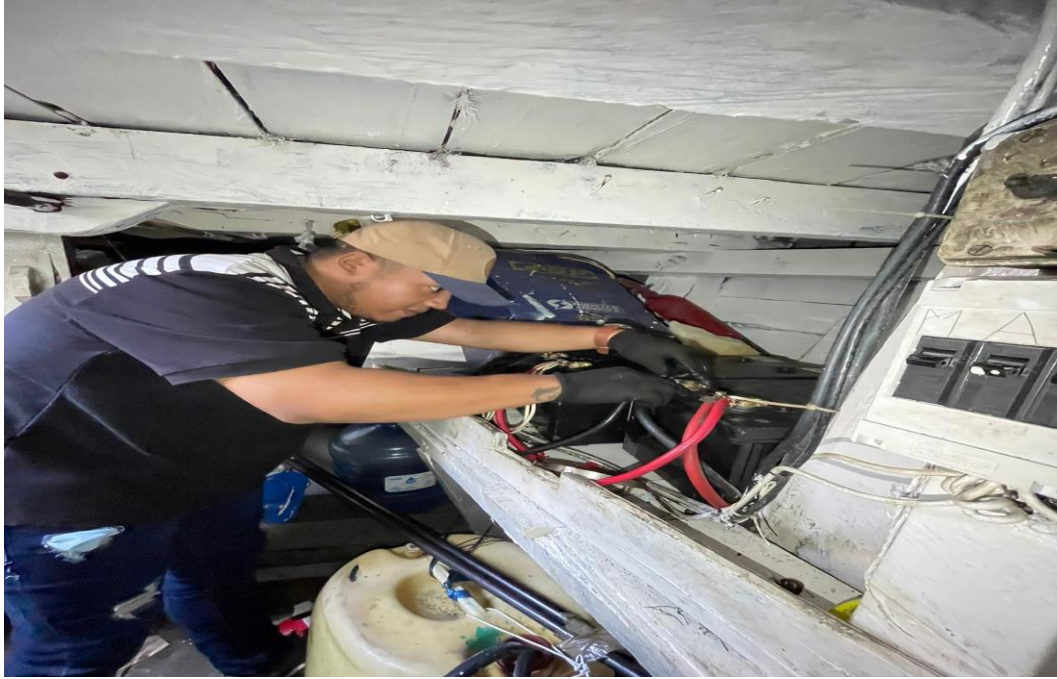
Conexión de las baterías para proporcionar energía para arrancar el motor.
