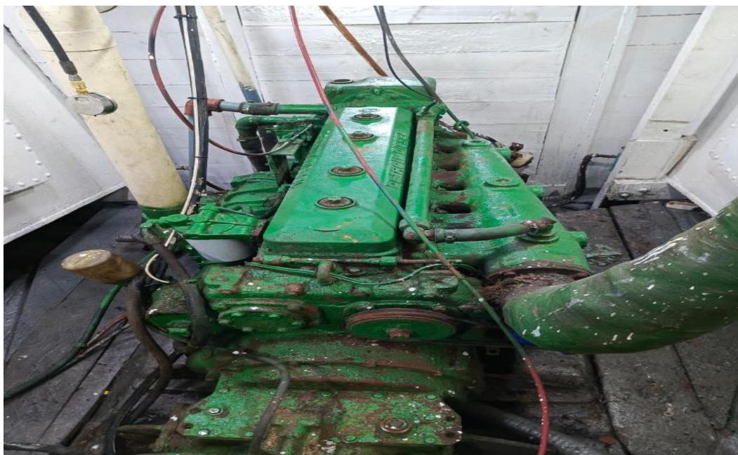
Cambio de banda y sistema de lubricación de la maquina principal del B/P 'El Rey'.
