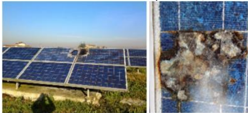
Ilustración 8 Paneles sobrecalentados, por el efecto sombra.
