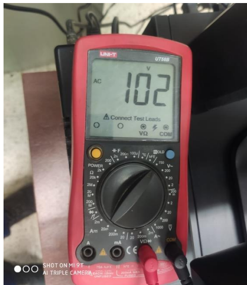
Anexo 2. Medición del voltaje
