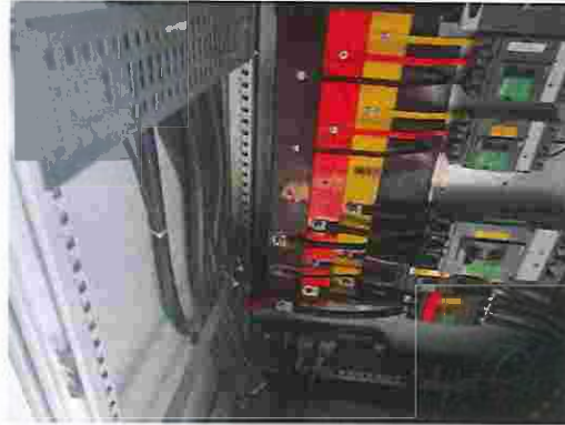
Figura 12: Ejemplo de arco eléctrico en tablero
