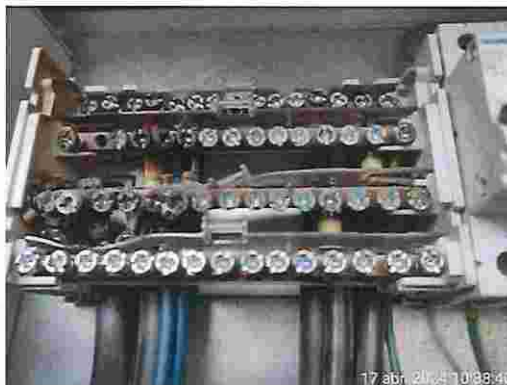
Figura 7: Ejemplo de sobrecarga de circuito
