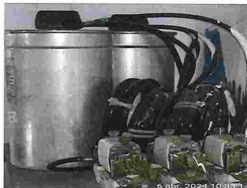
Figura 8: Ejemplo de conexión defectuosa
