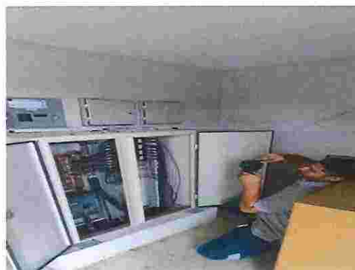
Figura 6: Fotografía térmica a Tablero Eléctrico
