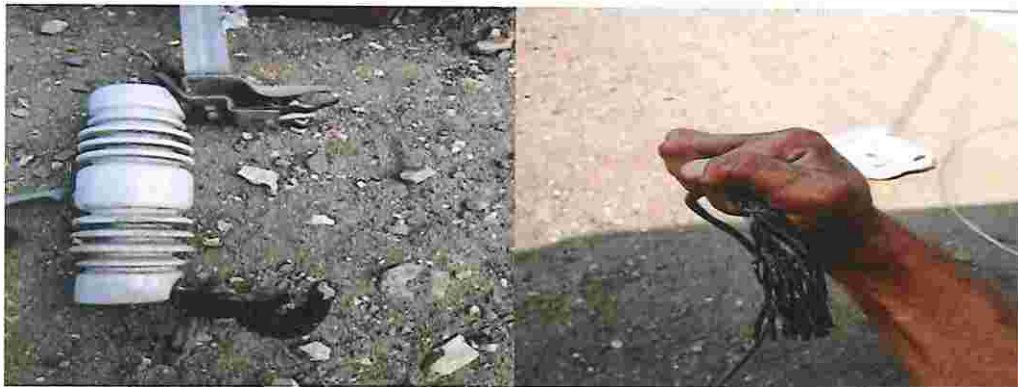
Figura 11: Ejemplo de fallo de dispositivo de protección
