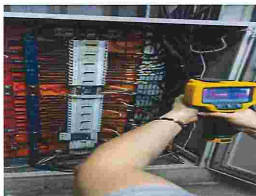
Figura 13: Ejemplo de termografía a tablero
