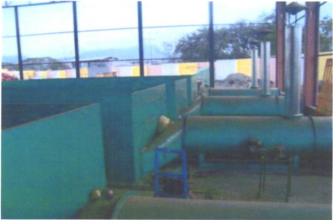
SISTEMA DE QUEMADOR CON INTERCAMBIADOR DE CALOR
