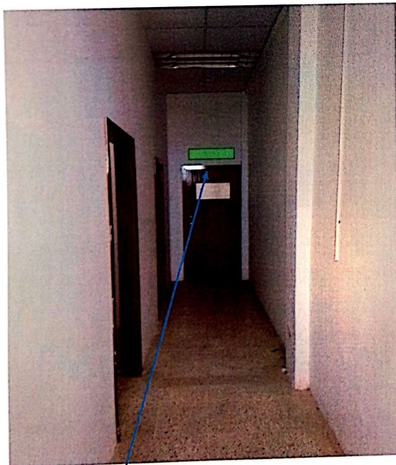
SALIDA DE EMERGENCIA CON SEÑALÍTICA.
