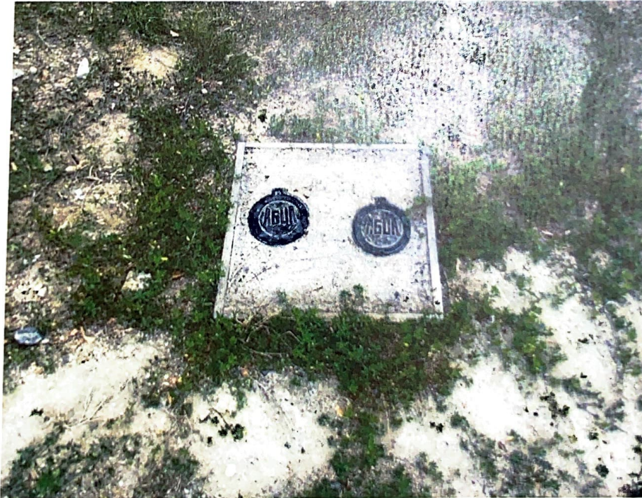
Anexo fotográfico 8. Válvulas Entrada de Jome
