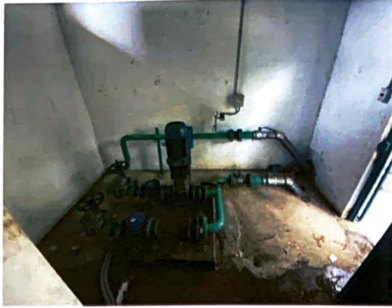
Figura 7. Sistema de Bombeo Sauces
