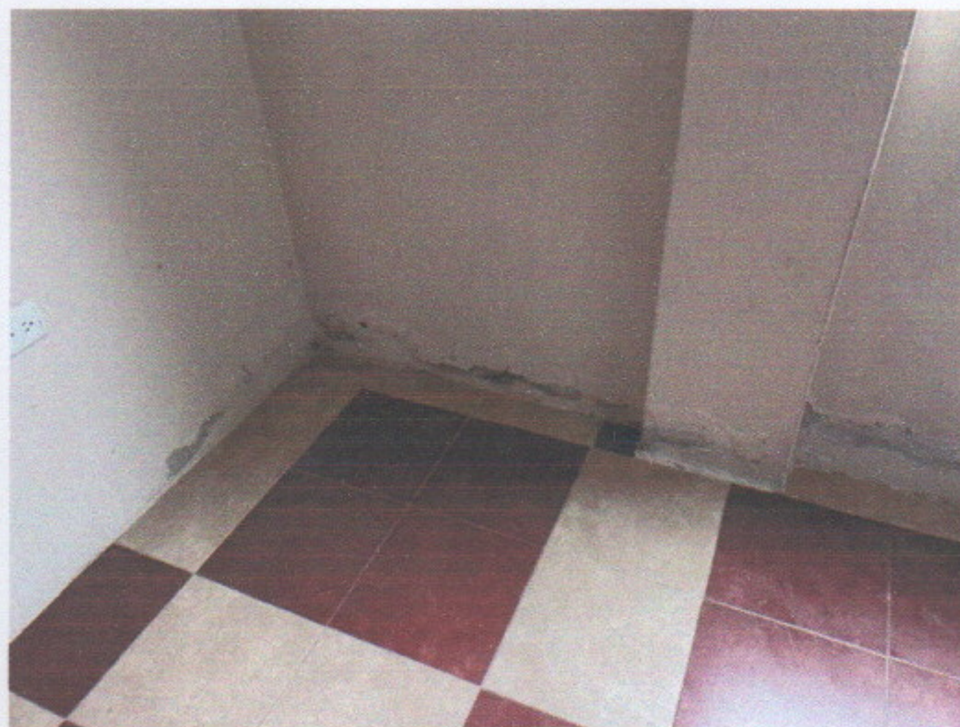
Ilustración 1: Humedad capilar en elementos verticales.
