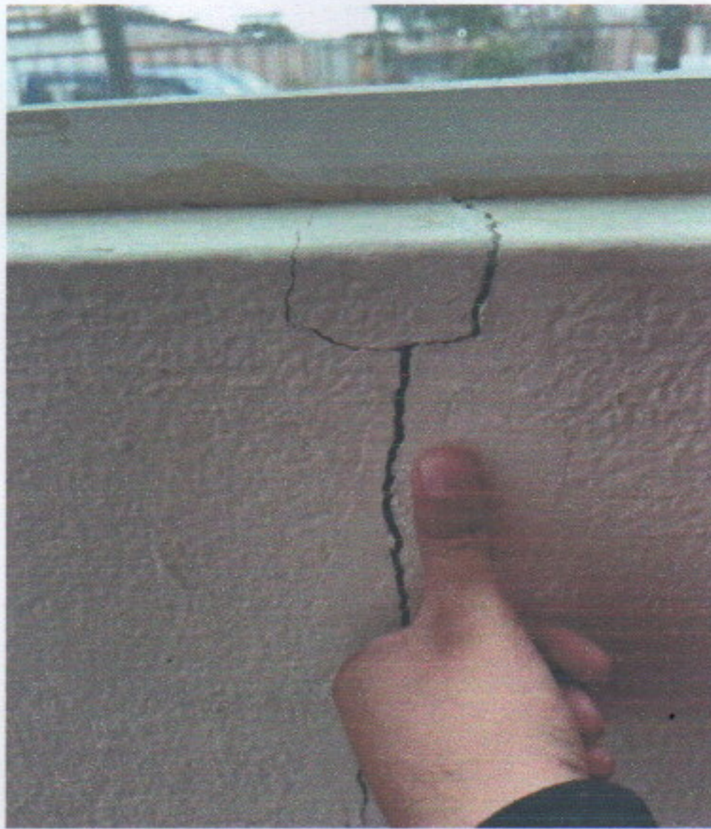
Ilustración 2: Grietas por posibles esfuerzos mecánicos
