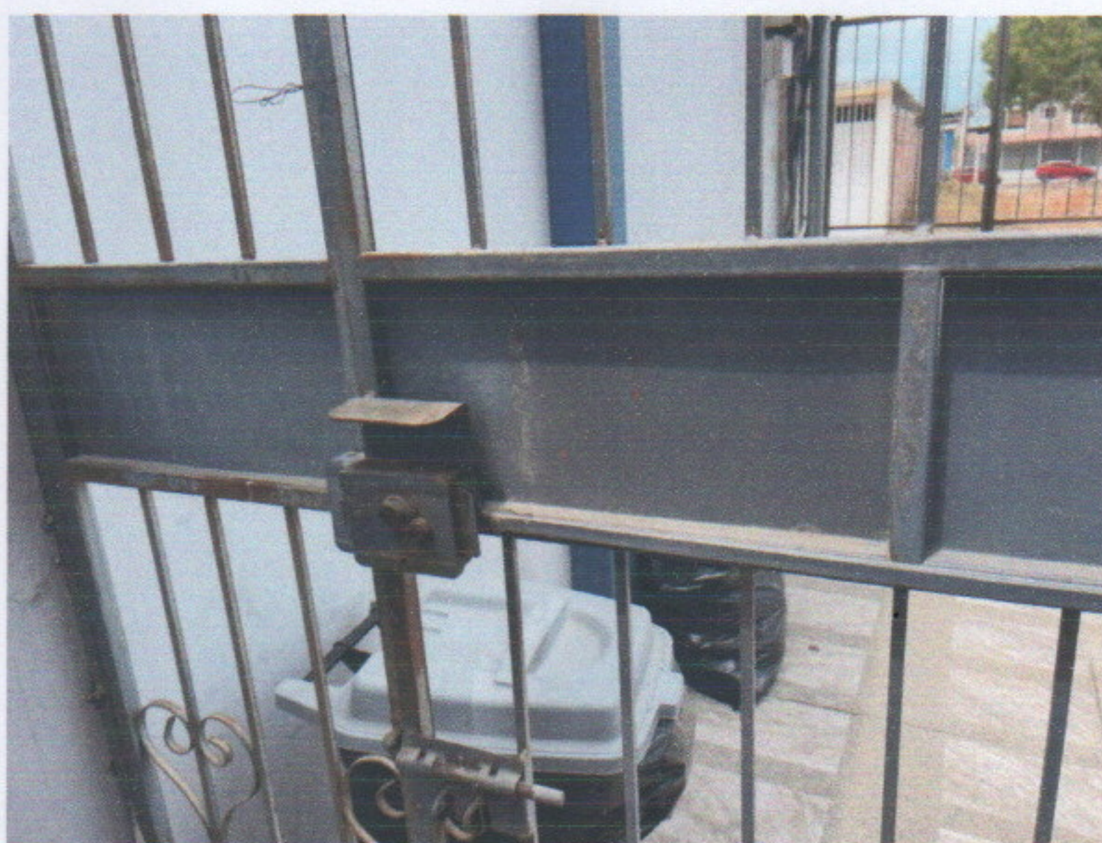
Ilustración 3 Oxidación en Carpintería metálica Fuente: Elaboración propia
