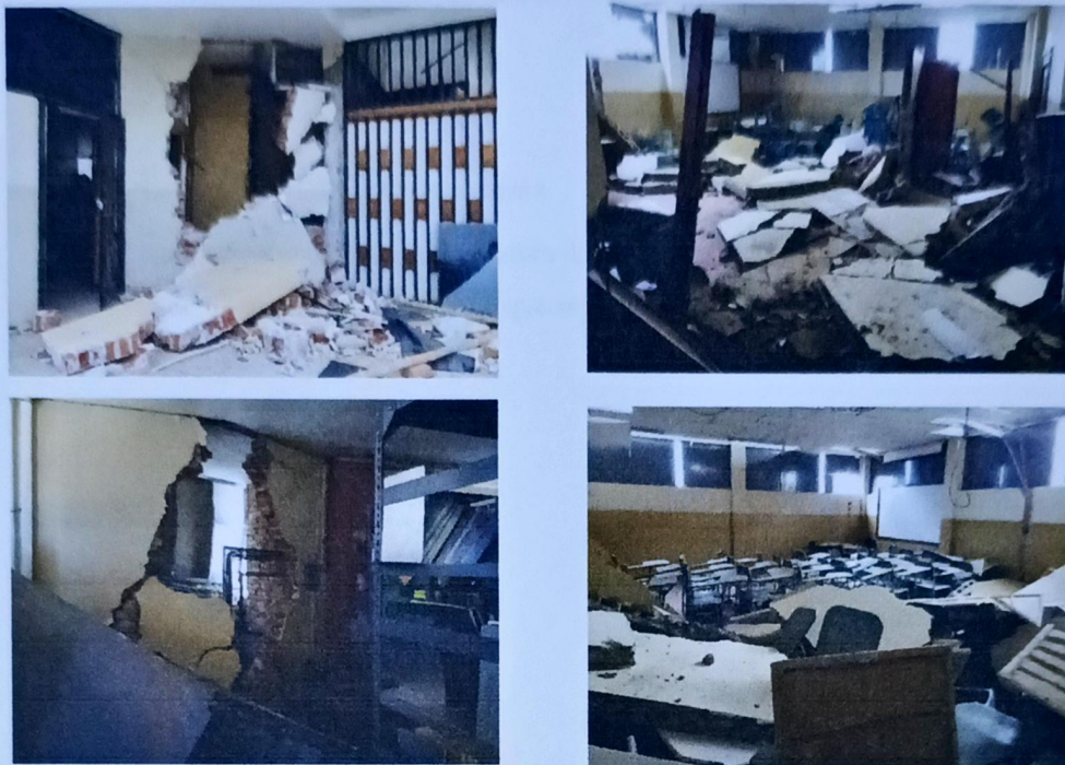
Figura 1. Daños causados en los edificios de la Uleam el 16 de abril del 2016
