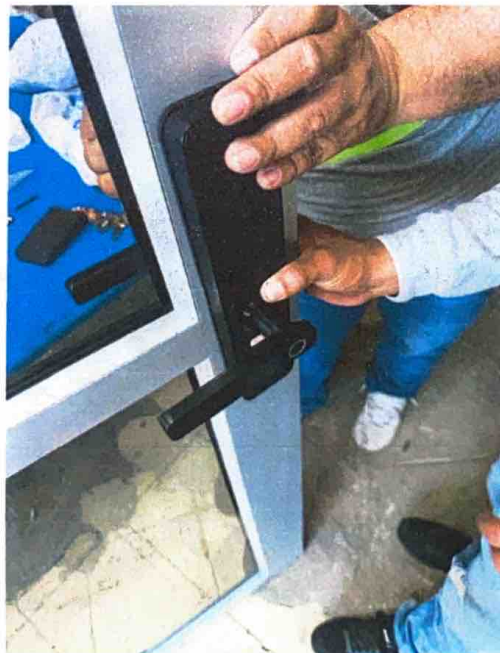
Figura No. 12. Colocado la cerradura inteligente en la puerta
