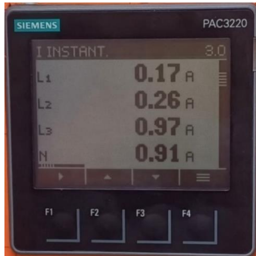
Figura 23: Parámetros de corriente de línea
