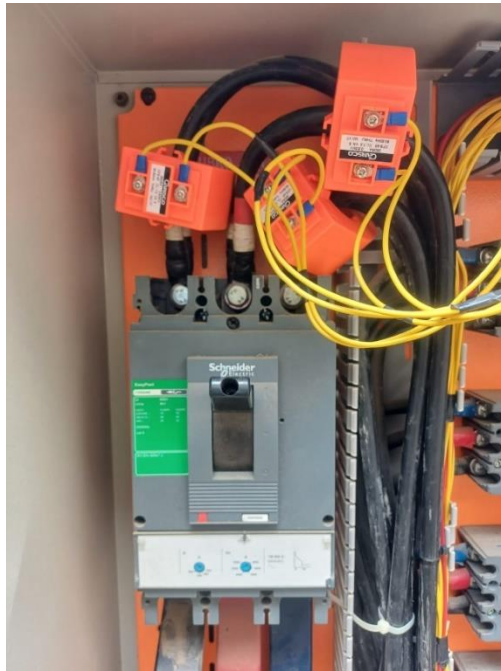
Figura 10: Transformadores de corriente en el breaker principal.
