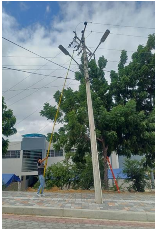
Figura 8: Desenergización de las líneas principales de la carrera de Arquitectura
