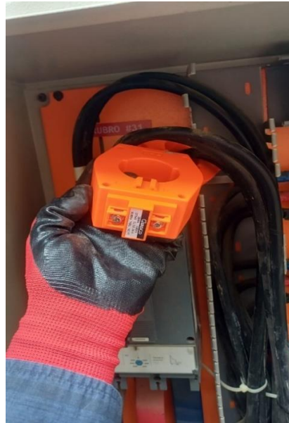
Figura 9: Colocación de los TC's en el breaker principal.
