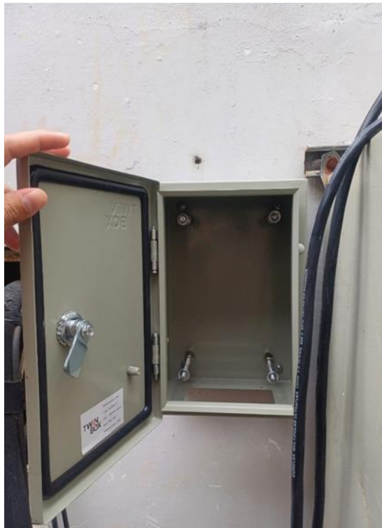
Figura 12: Tablero empotrado en la pared.
