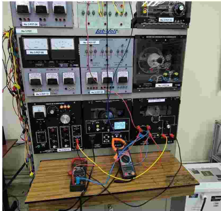
Conexión de equipos e instrumentación para práctica de banco de resistencias
