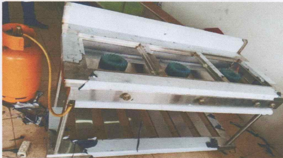
Verificación de hornillas en funcionamiento
