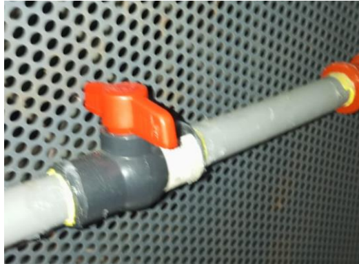
Ilustración 7 Válvula de Regulación (fuente propia)
