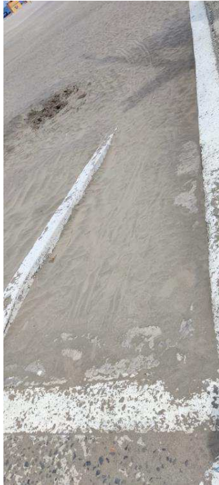
RAMPA DE ACCESO DE LA PLAYA MURCIELAGO (SIN MANTENIMIENTO)
