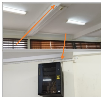
Figura 57 recorrido interno del cable de comunicación desde el medidor hasta el rack principal de Derecho
