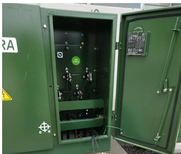
Figura 36 Transformador de 150KVA, lugar donde serán ubicados los TCs
