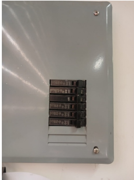
Figura 25 Caja de breakers de la sala de titulación
