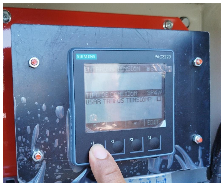
Figura 53 Se configuro el Tipo de conexión 3P4W, en el medidor SENTRON PAC 3220
