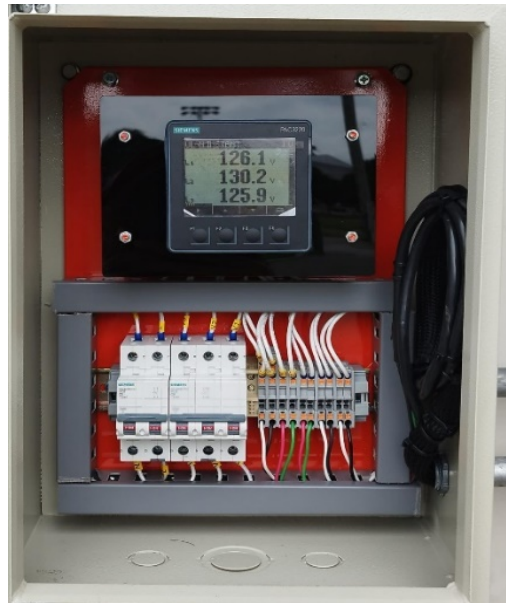
Figura 52 medidor Siemens SENTRON PAC 3320 YA ENERGIZADO
