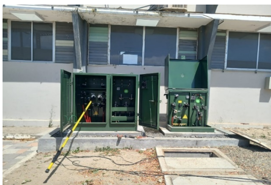
Figura 47 desenergización del transformador INATRA de 150 kVA de la facultad de derecho
