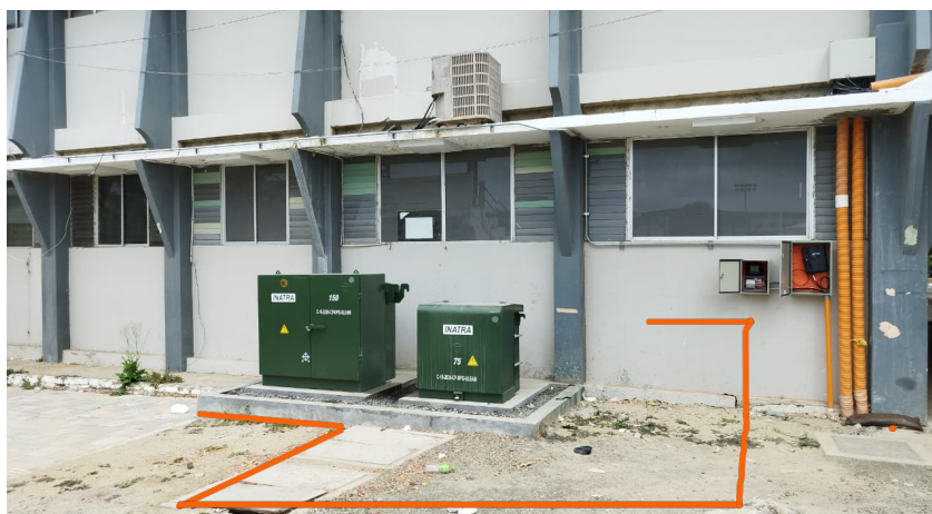
Figura 46 Recorrido del cableado de alimentación del Medidor de la facultad de derecho
