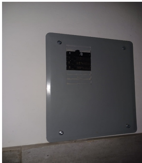
Figura 26 Caja de breakers del aula 104
