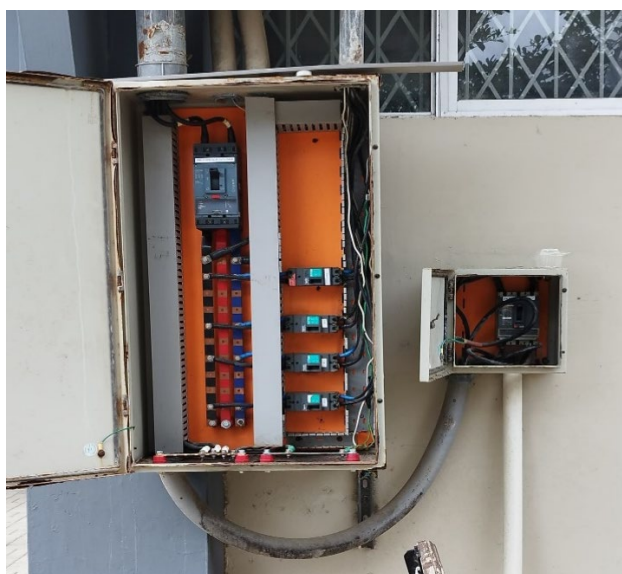
Figura 20 Tablero de distribución principal de la Facultad de Derecho
