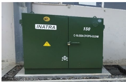
Figura 19 Transformador Inatra de 150KVA
