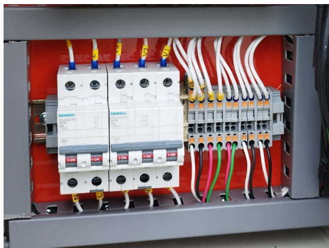
Figura 50 Tablero del medidor de la Facultad de Derecho con la conexión del cable concéntrico en las borneras con la identificación con la tabla 26
