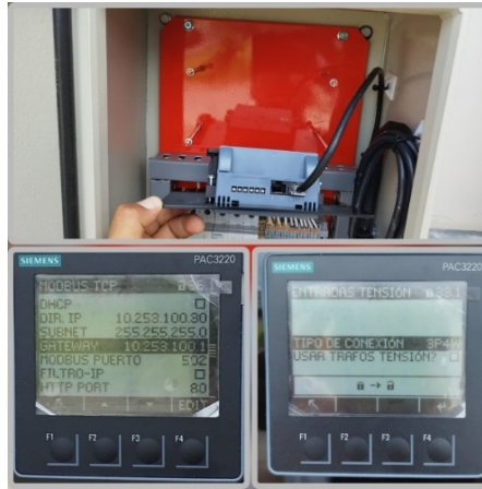
Figura 58 Conexión del cable de red al medidor y al rack principal de la Facultad de Derecho, bloqueo de la pantalla
