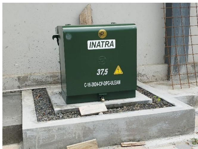
Figura 22 transformador INATRA de 37.5 KVA
