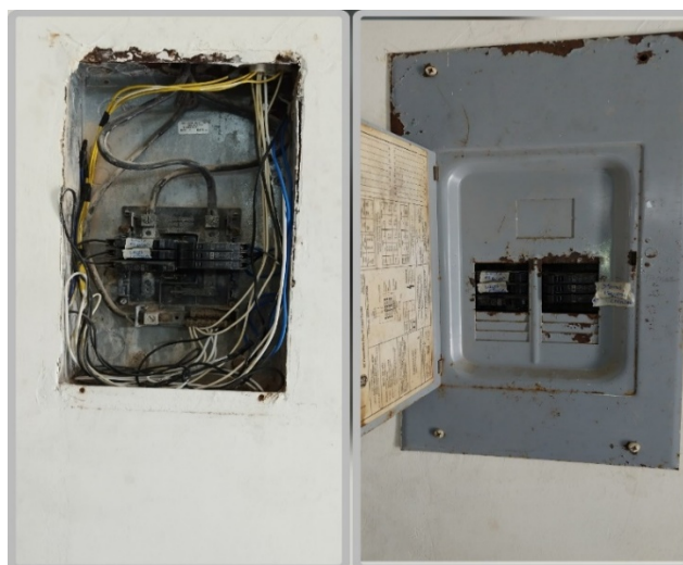
Figura 28 Caja de breakers que alimenta al auditorio externo de Derecho
