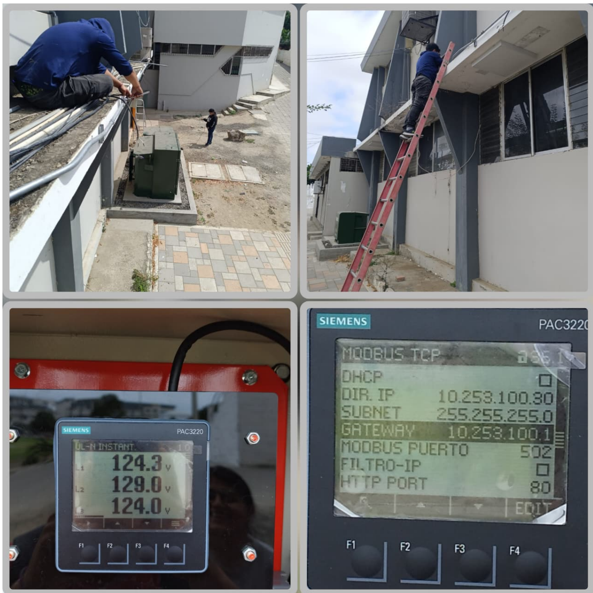
Anexo 18 Instalación del cable de comunicación medidor Siemens SENTRON PAC 3220 en la Facultad de Derecho, designación de la IP.
