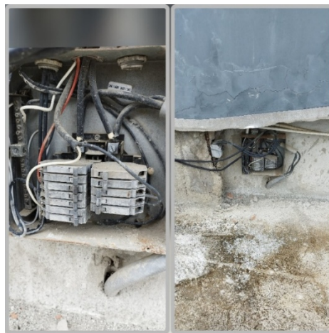
Figura 29 Caja de breakers encima del Auditorio de Derecho
