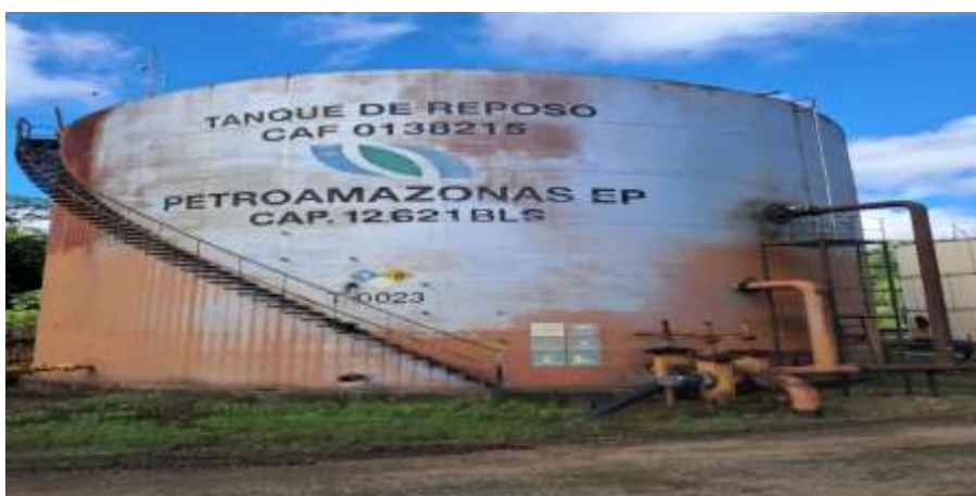
Foto 10 Tanque de reposo de crudo en instalaciones de Petroamazonas EP – Componente clave en la gestión de almacenamiento
