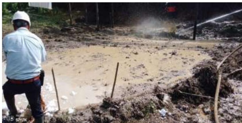
Foto 3 Remoción o limpieza de áreas contaminadas por derrames Remoción o limpieza de áreas contaminadas por derrames
