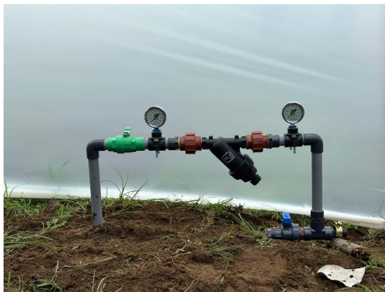
Ilustración 16. Medición y filtrado del sistema de riego por microaspersión
