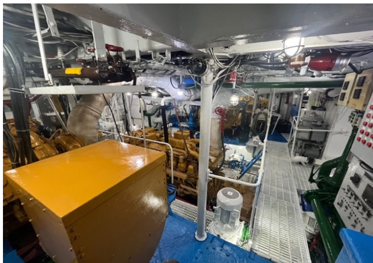
Figura 11. Sala de máquinas del B/P Cap. Tino B.
