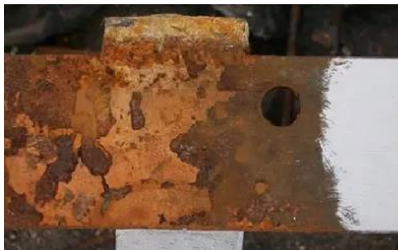
Figura 1: Corrosión Generalizada (Zavaleta, 2019)
