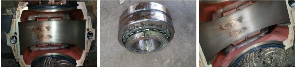
Figura 5:Corrosión por contacto (SEDISA)
