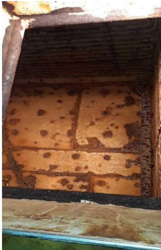
Figura 1. Estado de la cuba antes de mantenimiento
