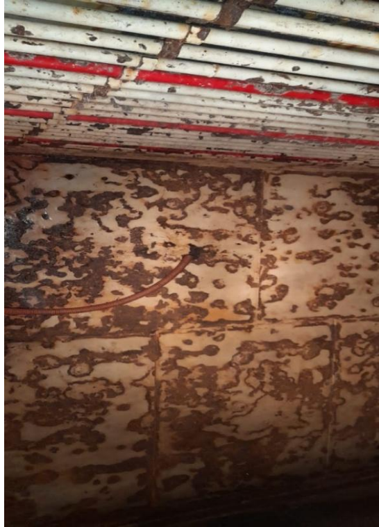
Figura 3. Estado de la cuba antes de mantenimiento
