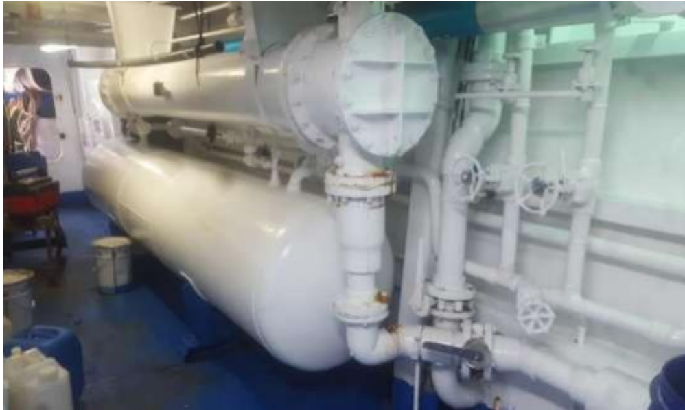
Figura 4. Tanques de Amoníaco
