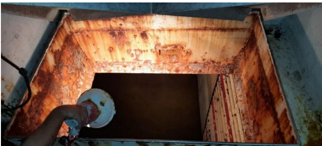
Figura 2. Estado de la cuba antes de mantenimiento
