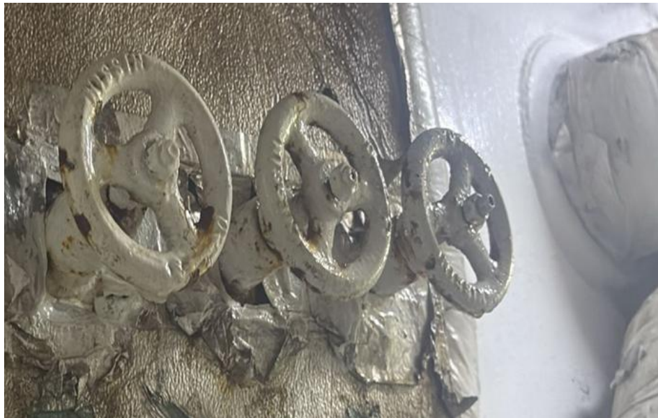
Figura 21. Válvulas para accionar el amoniaco a los serpentines
