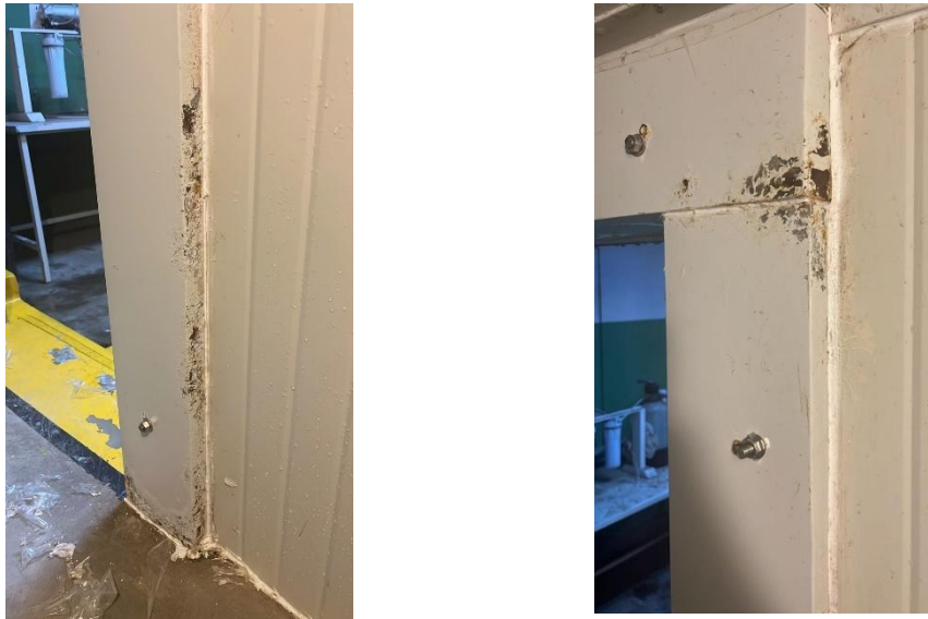
Ilustración 23 Oxidación en la entrada del recinto frigorífico.
