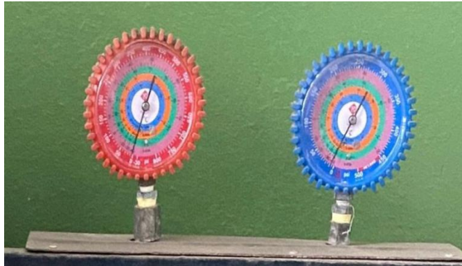
Ilustración 22 Lectura de presiones en el sistema de refrigeración con manifold de manómetros.
