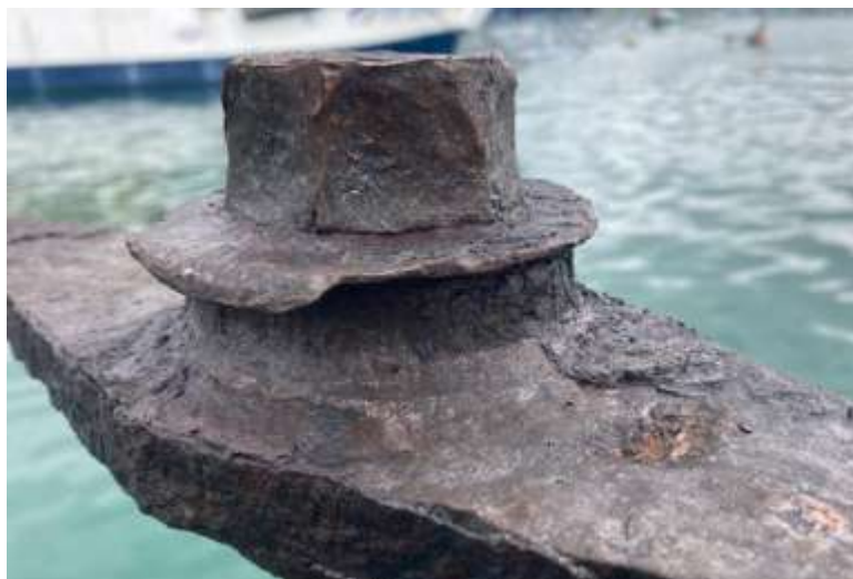
Ilustración 38 Tuerca del abanico deteriorada
