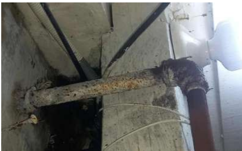
Ilustración 28 Accesorios con gran daño corrosivo
