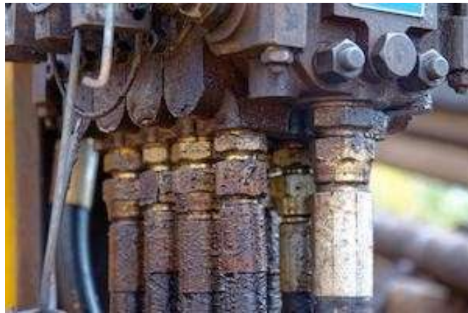
Ilustración 7 Fuga de fluido hidráulico en equipos industriales
