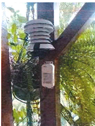
Ilustración 10. Instalación de Data Logger para temperatura ambiental con su escudo de radiación solar.
